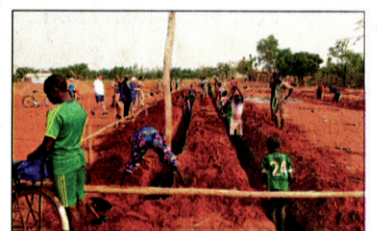
Selbst die Kinder packen an, wenn das ganze Dorf die Baugrube für den Schulhausbau aushebt.
